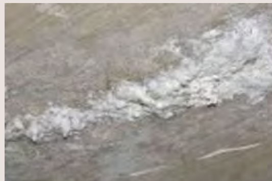
Esempio di un'efflorescenza secondaria in un garage esposto al sale diluito sulle strade proveniente dai veicoli che vi si recavano durante l'inverno.
