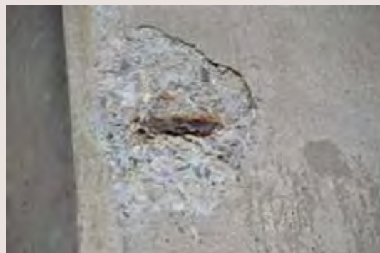
Esempio di un pezzo di cemento staccatosi insieme al ferro tondino corrosivo sottostante.
